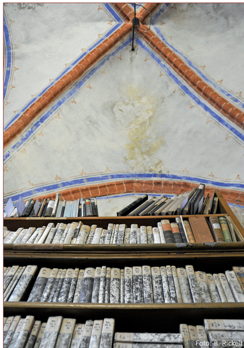
Kirchenbibliothek 2011, mit großen Schäden vor der Restaurierung.
